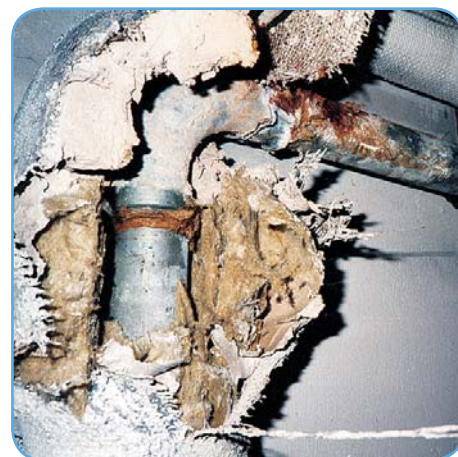
Putkiston eristeet on poistettu löytyneen vuotokohdan korjaustoimenpiteitä varten.
